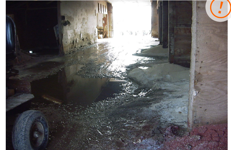
Wasserschaden im Speditionslager
